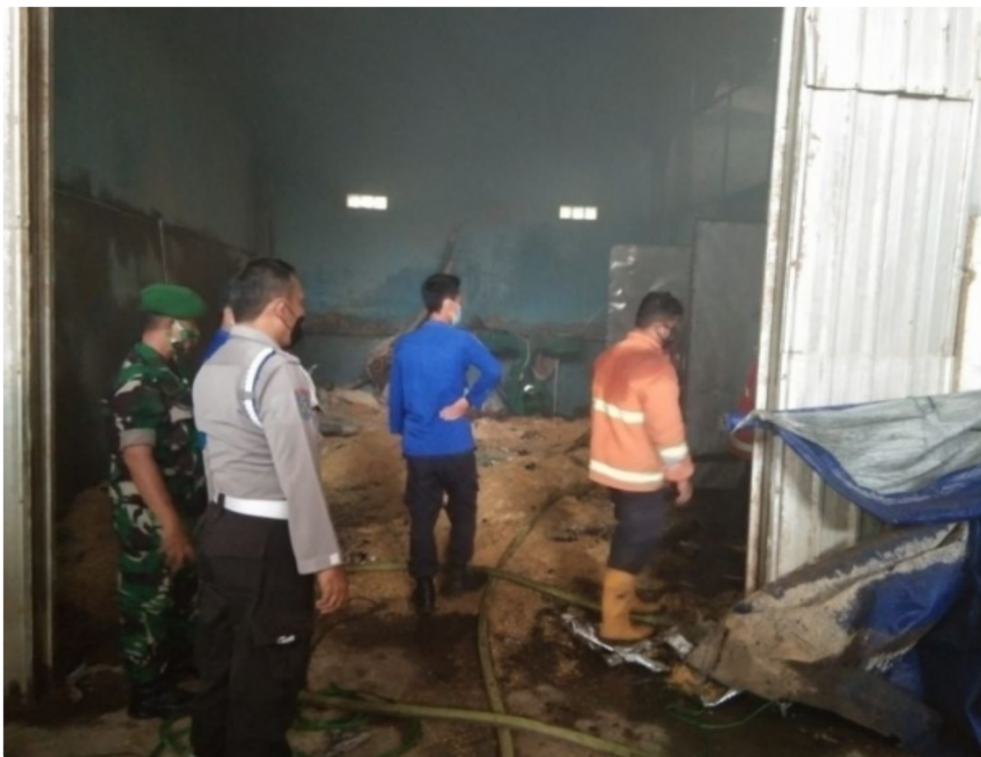
Pabrik Kayu di Kaligondang Terbakar
